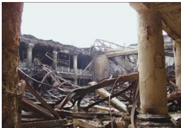
Рис. 4. Прогрессирующее обрушение конструкций во время пожара в здании, которое эксплуатировалось долгое время
