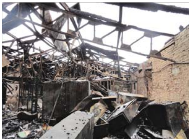
Рис. 3. Деформированные металлические конструкции в эпицентре пожара
