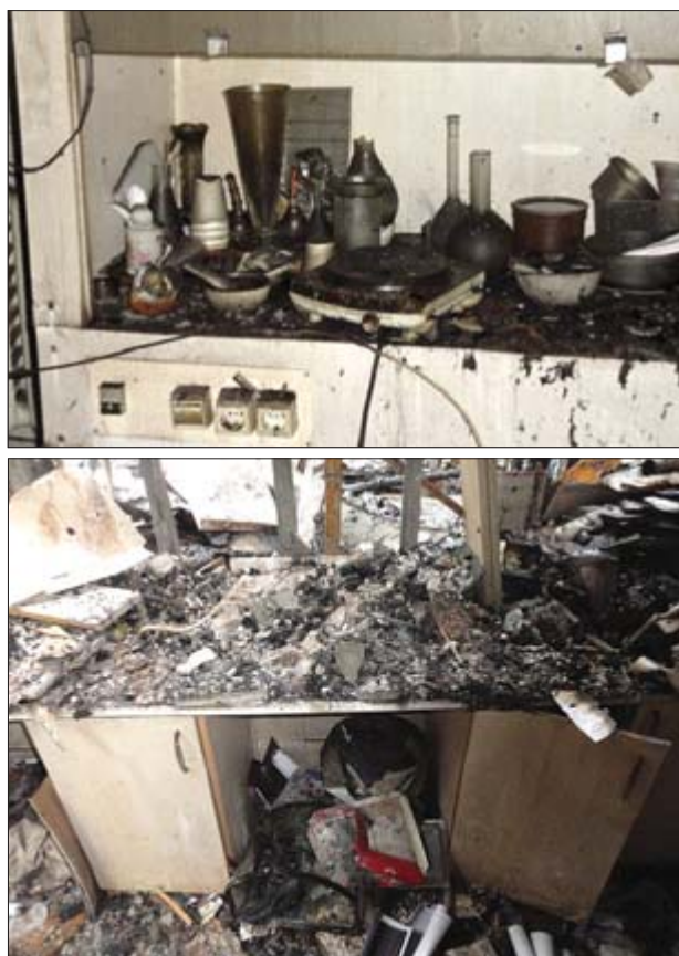
Рис. 1. Химическая лаборатория на чердаке после пожара
