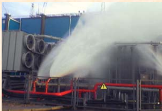
Рис. 1. АУПТ на ПС 500 кВ Новокаширская
