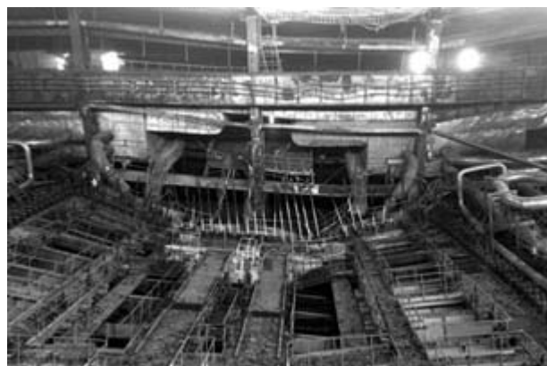
Рис. 2. Общий вид последствий пожара 1 февраля 2016 г. на энергоблоке № 3 Березовской ГРЭС в Шарыповском районе Красноярского края
