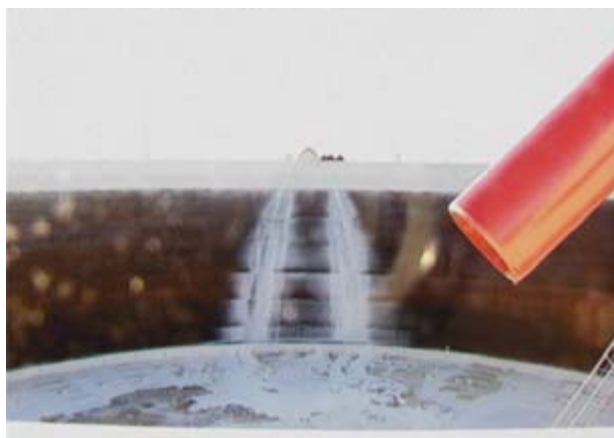
Рис. 14. Иллюстрация неравномерной работы системы подачи пены сверху в кольцевой зазор плавающей крыши резервуара: один слив подает пену слабой струей, а другой (красная труба) еще не работает (пена к нему не поступила)
