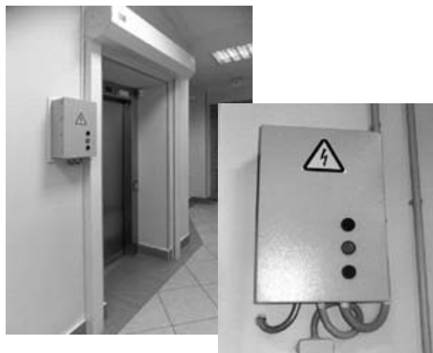
Рис. 16. Общий вид противопожарной шторы с блоком управления
