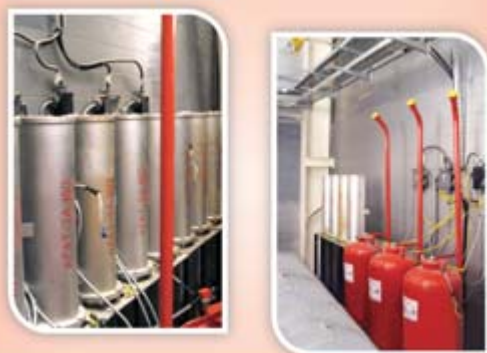
Установки аэрозольно-порошкового пожаротушения
