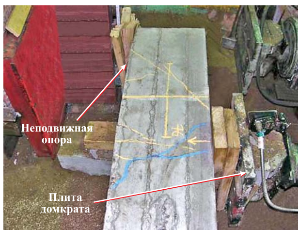
Рис. 3. Характерные трещины при разрушении бетона вблизи петлевого стыка
