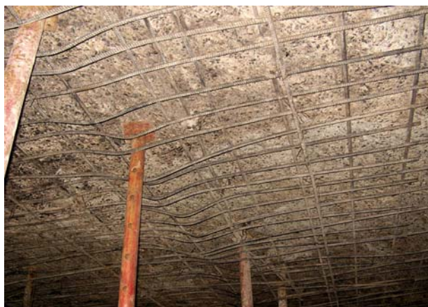
Рис. 4. Откалывание защитного слоя бетона и оголение арматуры
