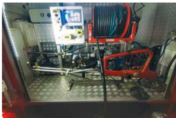
Рис. 7. Установка пожаротушения КОБРА (авторское фото) Fig. 7. Fire extinguishing unit KOBRA (author's photo)
