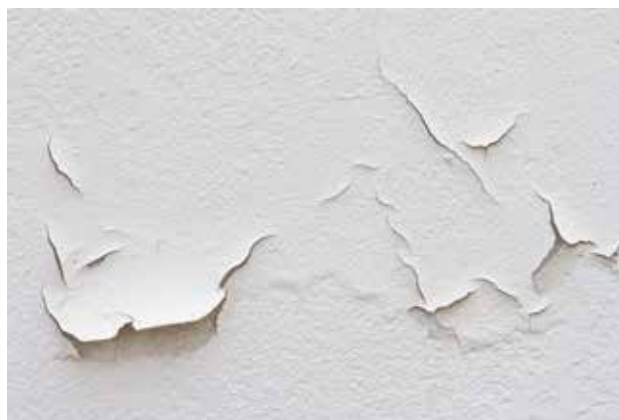
Рис. 7. Отслаивание лакокрасочного покрытия в процессе естественного старения
