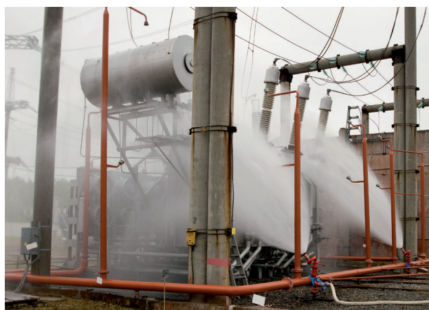
Рис. 3. Пример использования РУП для защиты трансформаторной подстанции
