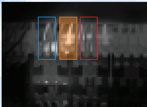
Рис. 2. Термограмма ТИКС «Снегирь» кабелей, подключенных к силовым электрическим автоматам. В контуре 2 (оранжевый) зафиксировано превышение пороговой температуры 60 °С. В контурах 1 и 3 (синий и красный) превышение пороговой температуры отсутствует
