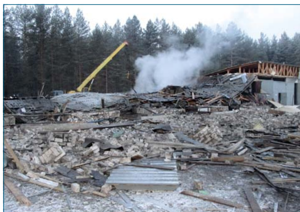
Рис. 2. Здание административного корпуса ООО «НоваКомПСВ» после аварии
