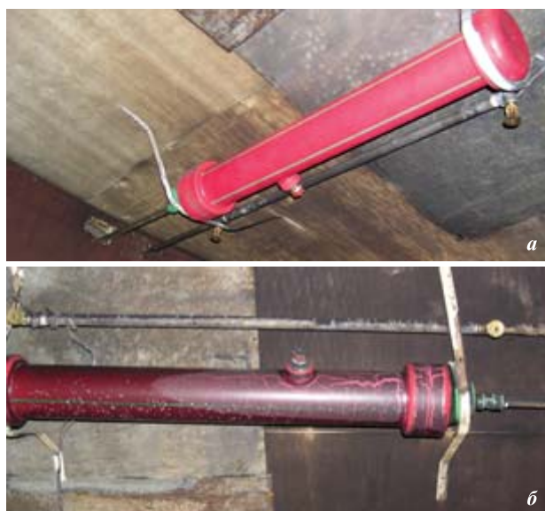
Рис. 3. Состояние трубы диаметром 125 мм до (а) и после (б) испытаний при максимальной температуре пожара 340–500 °С
