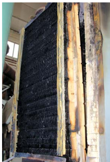
Рис. 2. Обугливание фрагмента внутренней несущей стены, изготовленной из клееного бруса
