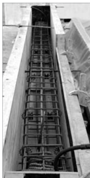
Рис. 1. Арматурный каркас опытного образца балки перед бетонированием (по технологии итальянской фирмы): в опалубочную форму установлены продольные и поперечные стержни ненапрягаемой арматуры, а также каналобразователь с протянутыми арматурными канатами при использовании технологии постнапряжения
