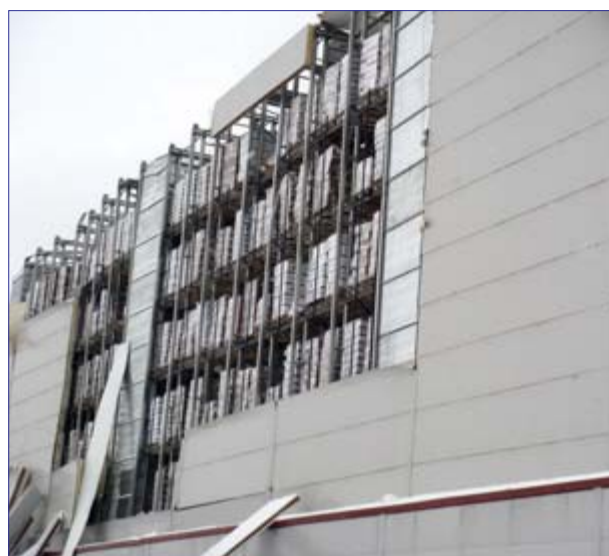
Рис. 6. Последствия локального аварийного взрыва в складском помещении
