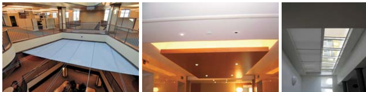
Рис. 6. Примеры использования огнезащитных штор в потолочных проемах
