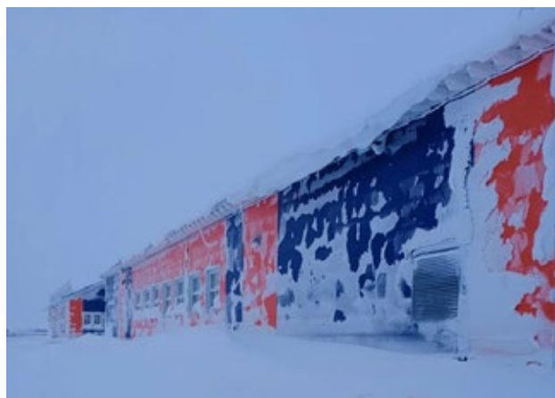
Рис. 4. Фото производственного объекта в Арктике. Снежные наметы на крыше, стенах, окнах
