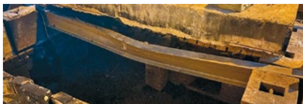
Рис. 5. Балка из стального проката С390П после проведения огневых испытаний
