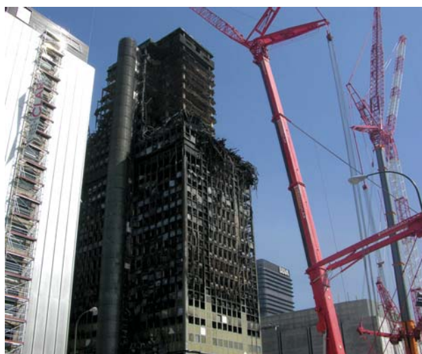
Рис. 1. Здание “Windsor Tower’s” в Мадриде после пожара Fig. 1. The Windsor Tower’s building in Madrid after a fire
