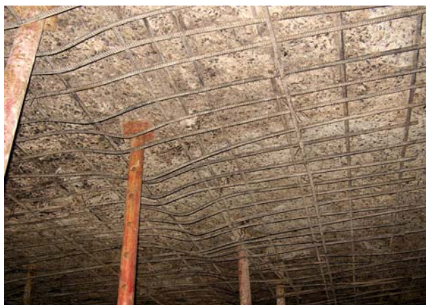
Рис. 4. Откалывание защитного слоя бетона и оголение арматуры
